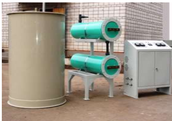
Рис. 2.15 Електролізна установка виготовлення розчину гіпохлориту натрію
