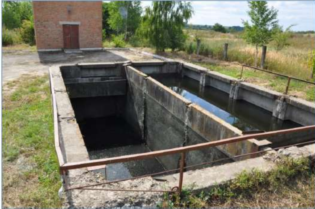
Рис. 1.9 Каналізаційні очисні споруди смт. Гоща
