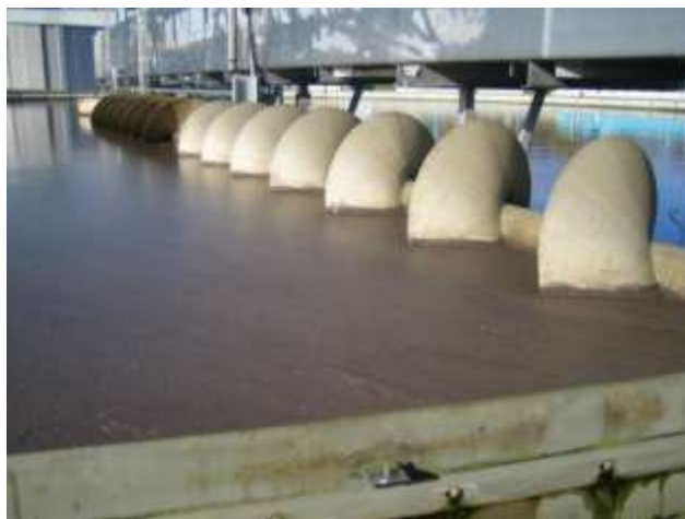
Рис. 2.13 Біотехнологія нітри-денітрифікації. Шнекова система збору поверхневої мулової корки у вторинних відстійниках (м. Шенфельд, Німеччина)
